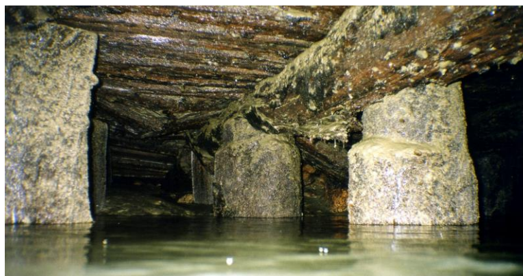
Figure 9. Exemple de détérioration du platelage en hêtre sous les quais du Grand Port Maritime de Rouen
