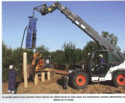
Le projet pieux bois permet entre autres de développer le bois dans les fondations comme alternative au béton ou à l'acier.
